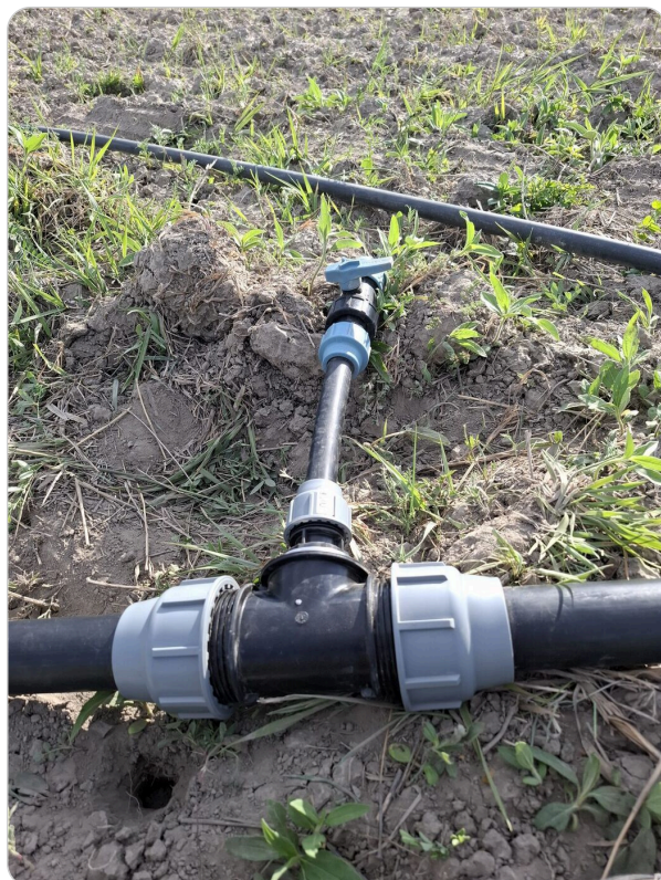
Fig. 15. – Té DN63 en place sur la nourrice, dérivation vers la rampe et vanne quart de tour d'équilibrage en tête
